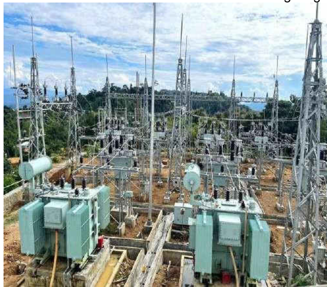
33/11 kV South Bungflang S/S
