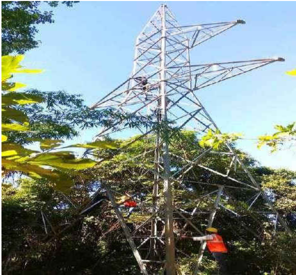
132 kV Chawngte – S.Bungflang TL
